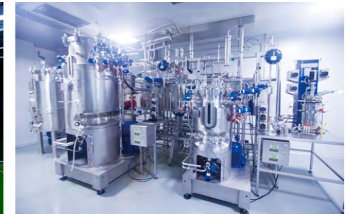
• 원료의약품생산시설(장비 71종 127대) 미생물 발효배양, 회수 분리정제, 여과농축
